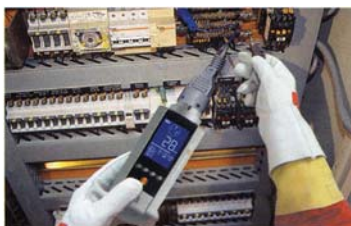
Контроль щита с помощью M-952271
